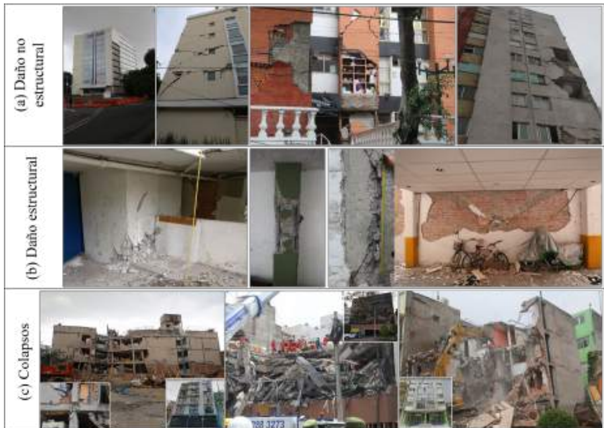
Figura 4. Ejemplos de daños observados: (a) daños no estructurales; (b) daños estructurales; y (c) colapsos.
