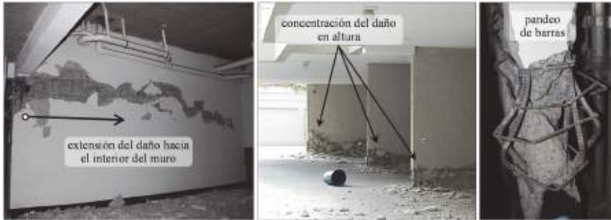
Figura 1 Daño en los extremos de muros estructurales durante el terremoto de Chile (2010) (adaptado de Arteta y Moehle, 2015).
